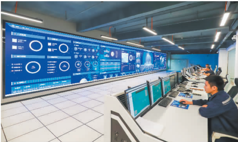
在大余县江西悦安新材料科技股份有限公司智能化控制中心,工人正依托数字化系统,对生产情况进行实时监控与智能化管理
