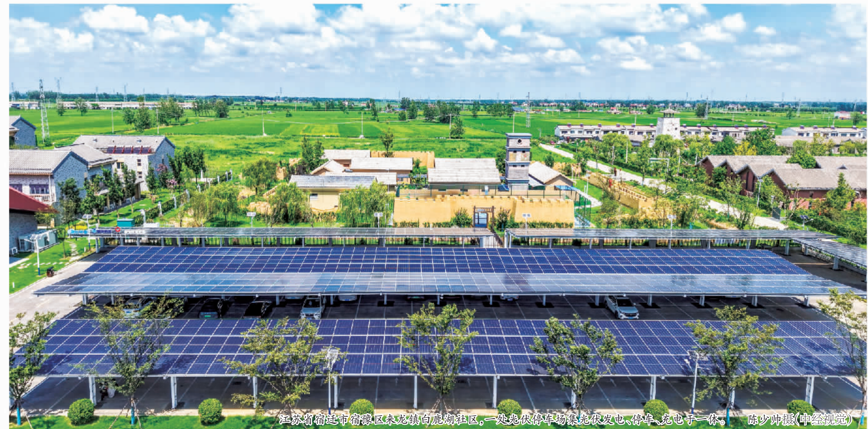
江苏省常州市武进区朱文镇南苑村，一处光伏扶贫电站光伏发电板，光伏电缆整齐排列。 陆少卿摄（中经视觉）
