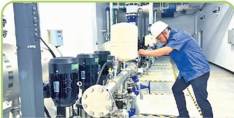
淮北市供水有限责任公司员工在淮北市相山区金方丽水园小区地下二次供水泵房内检查设备运转情况。
