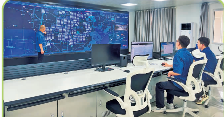
淮北市供水有限责任公司员工在监测淮北市二次供水管网运行情况。
