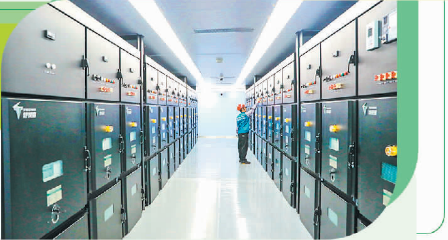
技术人员在青岛市崂山区全球首创算力中心高压交直流预制舱供电站(算电岛)进行带电运行安全保障。 张进刚摄(中经视觉)
