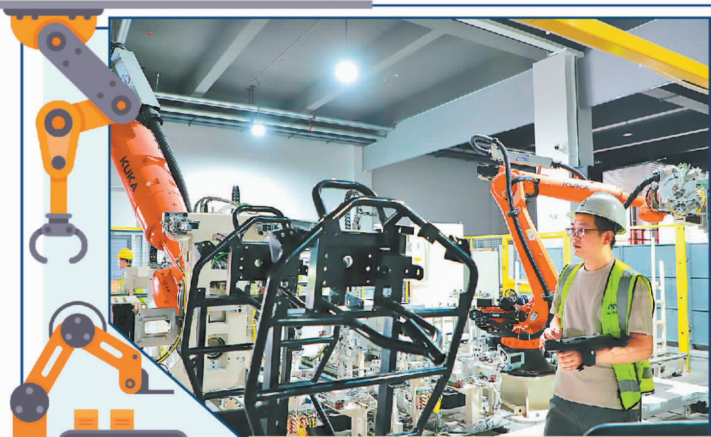
重庆大江动力新能源智能装备基地内，工作人员正在进行设备调试。
