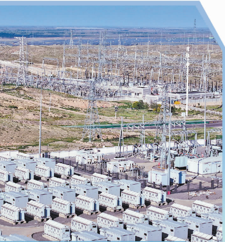
位于宁夏回族自治区银川市东部荒滩上的新型储能电站,将周边风电、光伏电站多余的新能源电量存储起来,助力能源保供。 袁宏彦摄(中经视觉)
