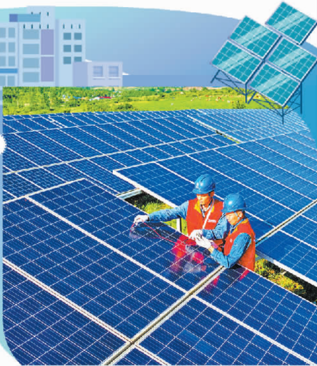
安徽省滁州市定远县吴晖光伏发电站,国网滁州市供电公司工作人员在对光伏发电设施进行巡检维护。 宋卫星摄(中经视觉)
