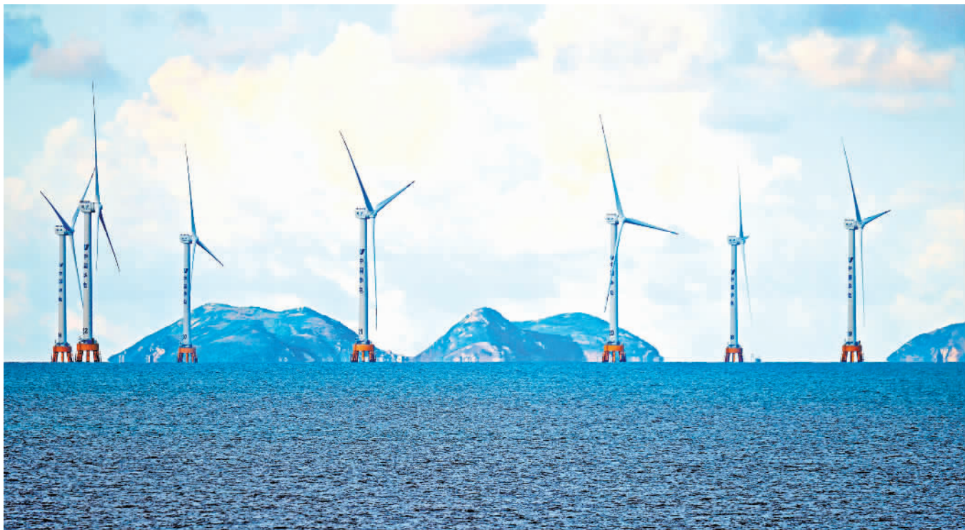
近日，在浙江省玉环市华电玉环1号海上风电场，风力发电机源源不断地输送绿色能源。该风电场是浙江东部沿海风电场群的重要组成部分。近年来，玉环市结合海岛地区土地少、资源少等实际情况，有效利用海面、地面、屋顶等资源，大力发展绿色能源，助推经济、生态双丰收。
