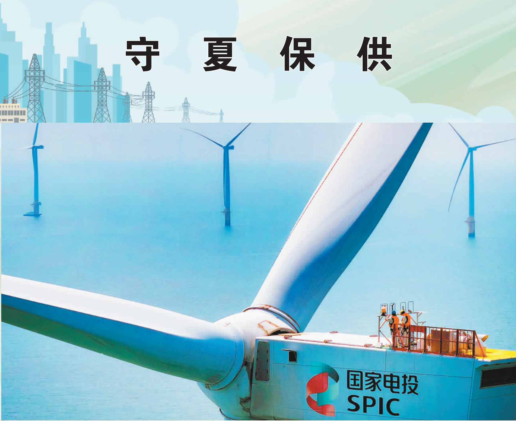
▲6月10日,江苏省国电投南通新能源有限公司如东H4、H7海上800兆瓦风电场,工作人员在维护风机,保障电力供应。 许丛军摄(中经视觉)
