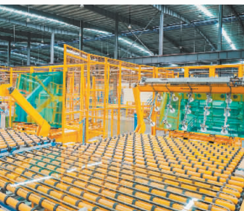
北海信义产业项目高端浮法玻璃及光伏玻璃生产线一角
