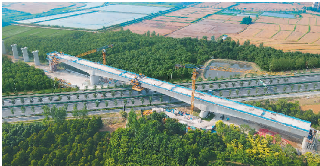
6月17日，在安徽省合肥市肥西县，合武高铁庐安特大桥跨G312国道连续梁顺利合龙，为后续桥面系及无砟轨道施工奠定了坚实基础。新华社记者 常磊摄
