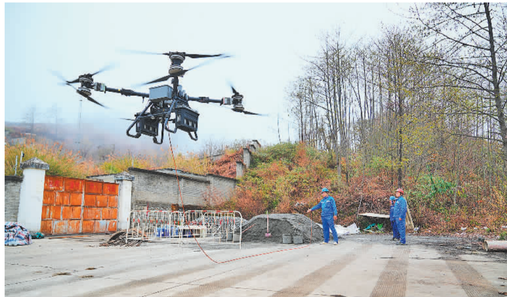
近日,藏东南至粤港澳大湾区±800千伏特高压直流输电工程云南段线路首基铁塔基础,在云南省怒江州贡山县开始浇筑,标志着该工程云南段线路进入施工阶段。图为南网超高压公司大理局建设者用重载无人机运输物料。吴志龙摄(中经视觉)
