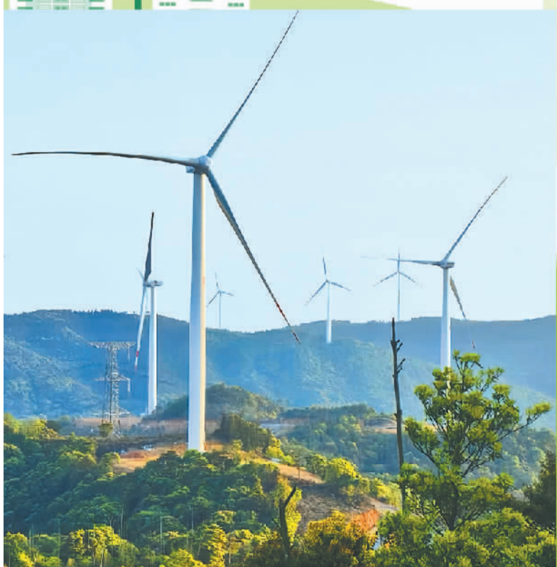
应用道莅智远产品完成主控改造的2兆瓦风电机组。
