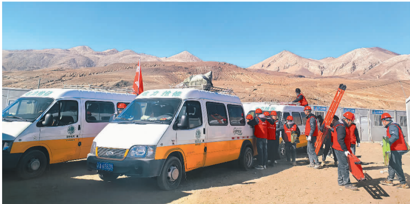
1月11日，在定日县长所乡森嘎村安置点，电力抢修人员忙着为板房铺设线路。
