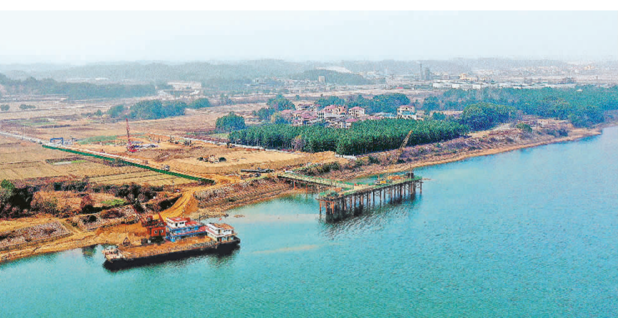
12月26日,江西省吉安市峡江县巴邱镇王家货运码头,工人正在施工。近年来,当地依托赣江“黄金水道”优势,加快码头建设,建立水运管理联动机制等,加快发展水运经济。
