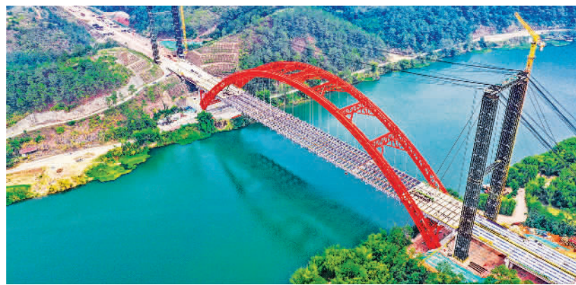
12月14日拍摄的广西梧州市藤县平岑高速公路北流河特大桥施工现场。该高速公路建成后将密切桂东和粤西城市群的联系，带动沿线地区经济社会发展。（颜桂海摄/中经视觉）
