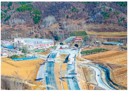
近日,由中国铁建投资集团投资建设的陕西在建最长高速公路隧道——眉太高速公路街岭隧道双线贯通,为全线如期建成奠定了坚实基础。 钱磊摄(中经视觉)
