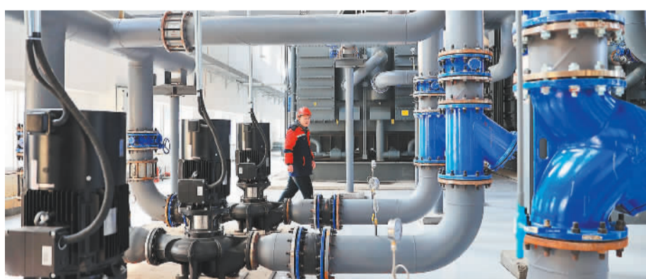
▲11月11日,山东东营新型城市清洁能源供热项目(一期)的登州路供热站,工作人员在检查设备。 周广学摄(中经视觉)
