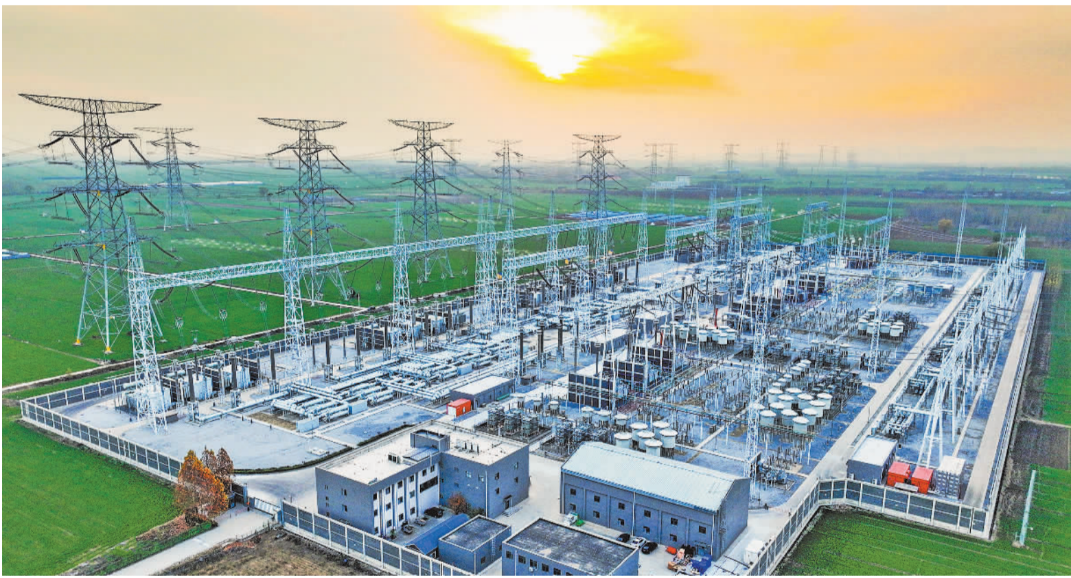
11月19日,河北省定兴县境内的雄安1000千伏特高压变电站扩建工程投运。该站是京津冀负荷中心的重要枢纽,也是连通雄安新区清洁能源大通道的关键站点。
