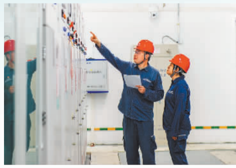
2024年4月2日,横琴粤澳深度合作区的20千伏沐琴台开关站顺利送电启动,开关站内创新试点应用了南方电网自主知识产权的电鸿物联智能配电网关技术和电鸿电器传感终端
