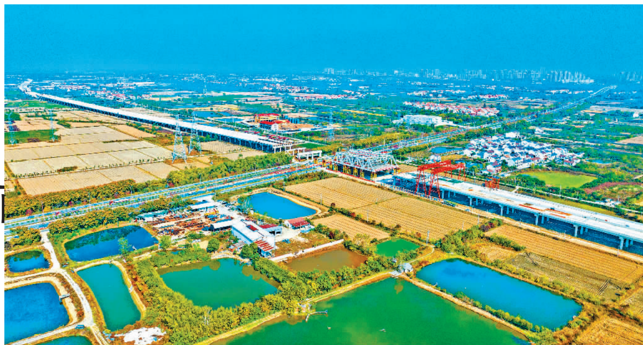
日前，由中铁十一局承建的新港高速双柳长江大桥及接线工程高家墩大桥跨河津大道钢桁梁开始顶推施工。该工程是武汉都市圈环线高速的重要组成部分，线路全长约35公里。建成后，将进一步优化武汉都市圈环线高速公路路网结构。古建教摄（中经视觉）
