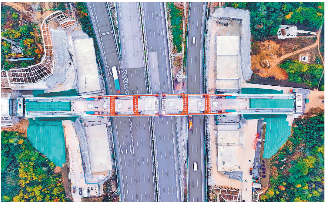
11月12日，安徽省马鞍山市含山县林头镇巢(湖)马(鞍山)城际铁路施工现场，跨芜(湖)合(肥)高速特大桥2个重达万吨的连续梁T构，同步完成“空中转体”，标志着国际上首例非对称连续梁带拱平转顺利对接，巢马城际铁路建设取得阶段性进展。
