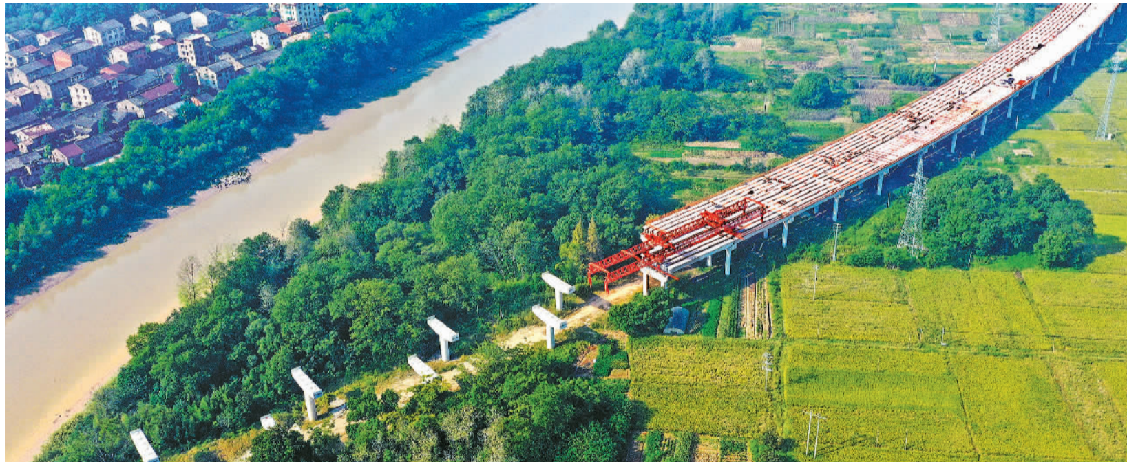
10月12日,乌瞰351国道浙江省临海市永丰镇建设现场,项目正在加紧施工。近年来,当地加大交通基础设施建设力度,建成以国省道为骨干、县乡道为支撑的交通网络,有效促进农产品流通和乡村旅游发展。
