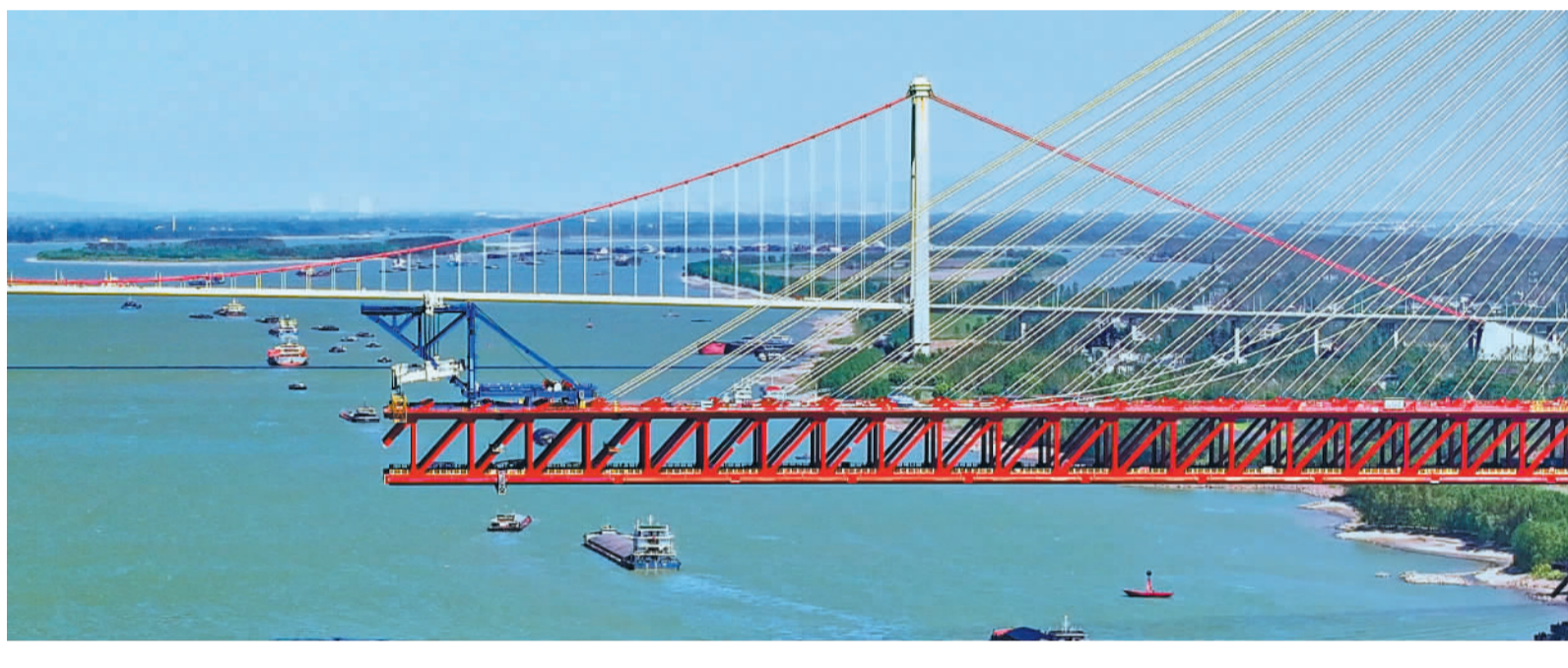
10月2日,安徽巢马铁路马鞍山长江公铁大桥项目建设场景。建设者抢抓金秋施工黄金期,奋战在工地一线,确保重点工程建设进展顺利。 王文生摄(中经视觉)
