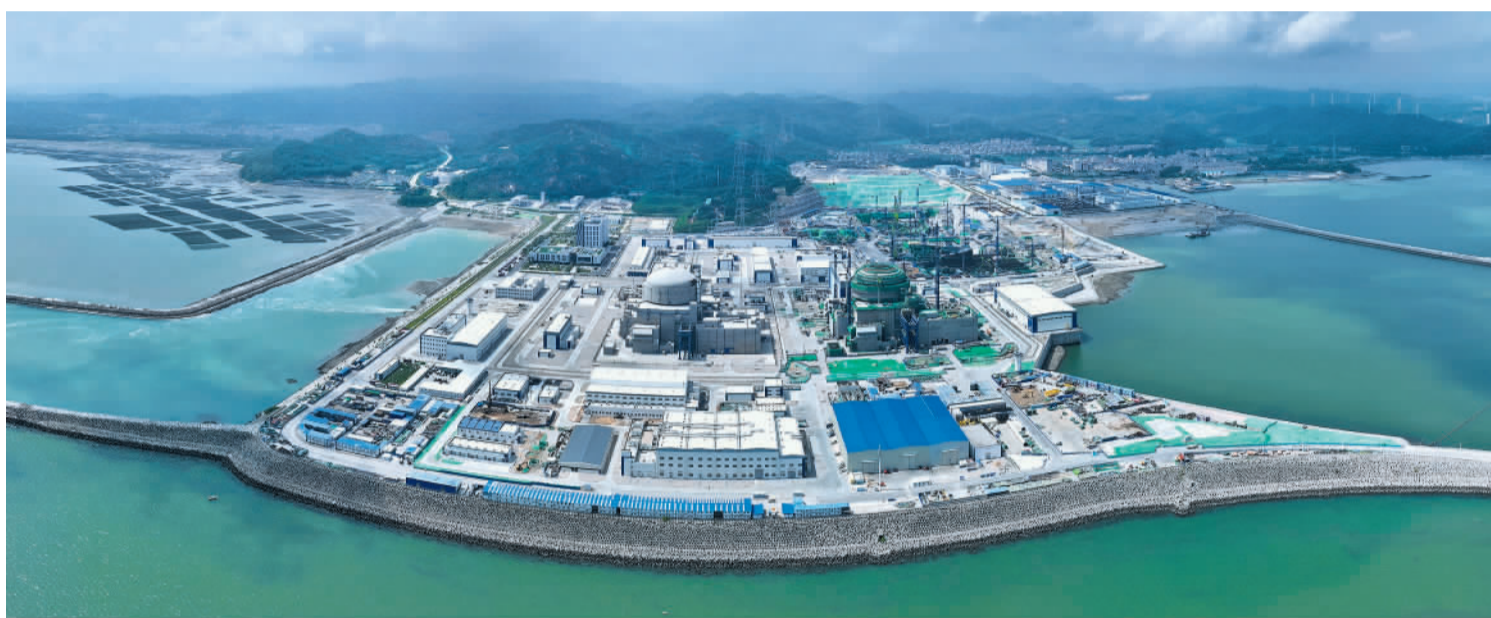
9月27日,中核集团漳州核电二期工程4号机组浇灌核岛第一罐混凝土,标志着漳州核电二期工程建设全面铺开。 新华社记者 林善传摄
