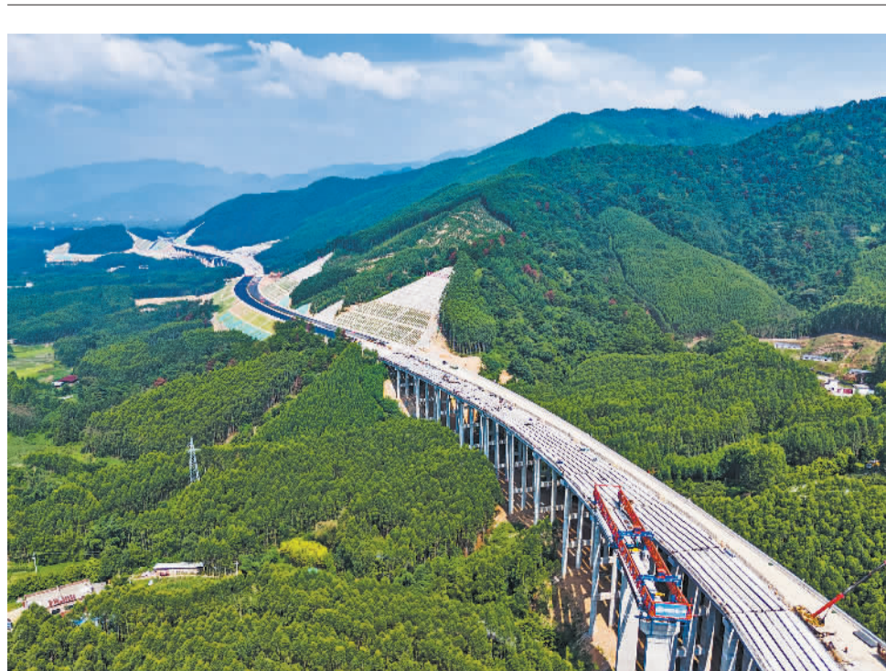
广西壮族自治区贺州北过境线高速公路项目第4标段建设现场,施工作业正有序开展。贺州北过境线高速公路项目主线全长50.5公里,建成后将进一步完善广西高速公路网络,方便群众日常出行,推动沿线经济社会发展。
