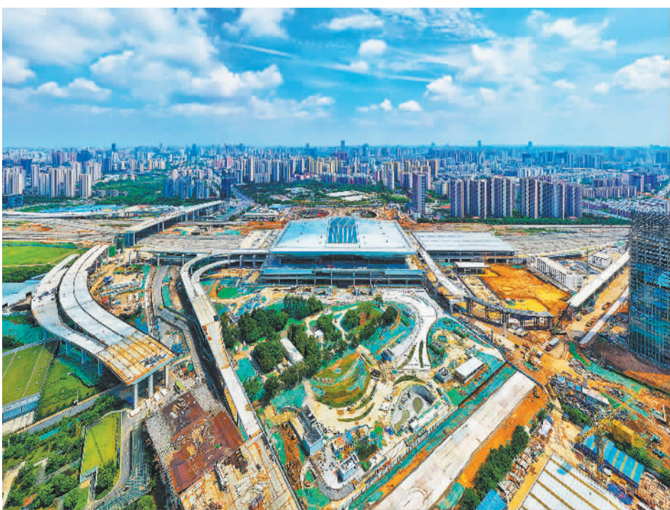
8月20日,安徽合肥新合肥西站项目建设现场一派忙碌景象。新合肥西站是国家“八纵八横”高速铁路网京港通道的重要客站,总建筑面积约24万平方米,设计规模8台18线。目前,西侧站房主体已经完工,预计2025年12月具备运营条件。 陈三虎摄(中经视觉)
