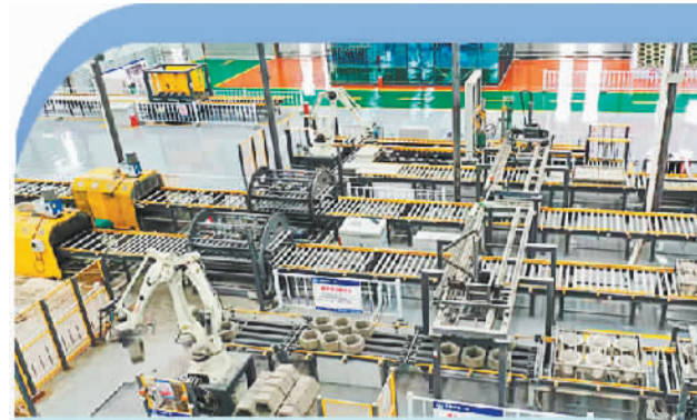
中铁一局西成高铁XCTJ5标智能轨枕厂智能化小型预制构件生产线。张根城摄
