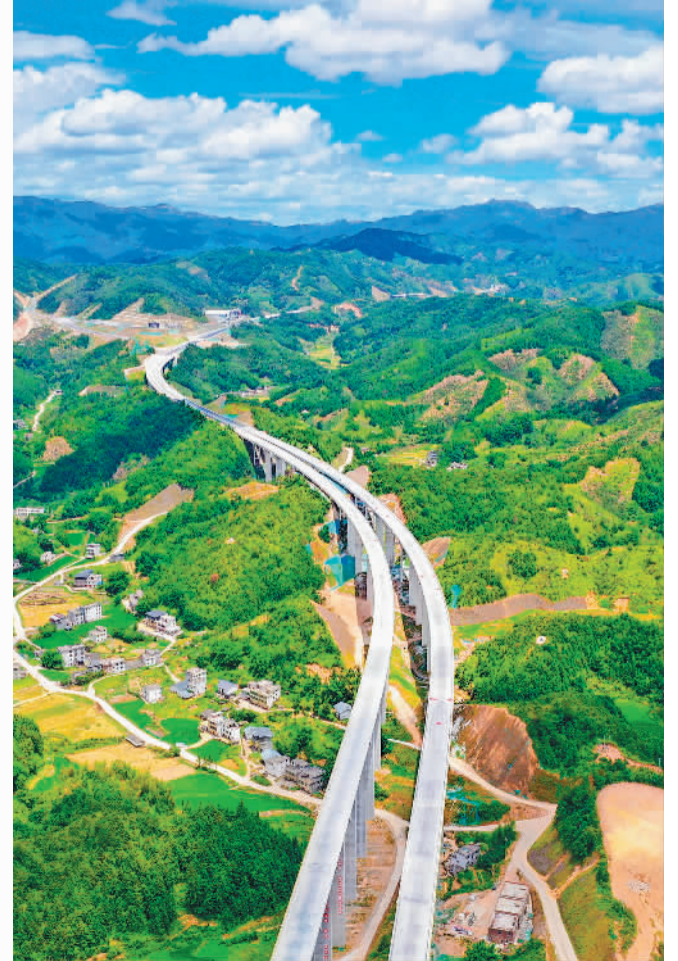
7月25日,江西省重点工程遂川至大余高速公路A标段路基一、四分部完成主体施工。工程竣工后将便利沿线群众出行,对推动当地经济发展发挥积极作用。 李建平摄(中经视觉)
