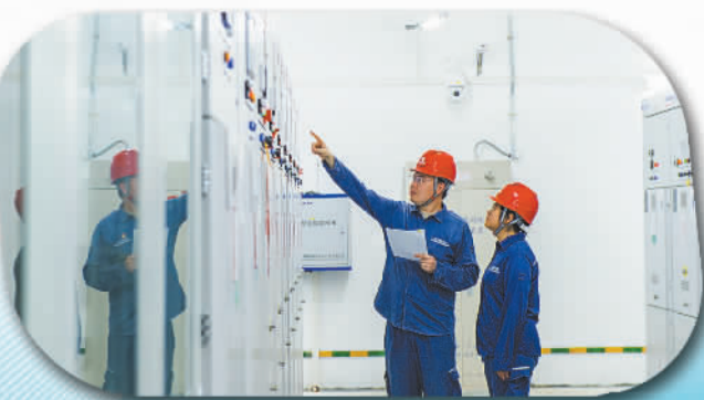
2024年4月2日，横琴粤澳深度合作区的20千伏天沐琴台开关站顺利送电启动，开关站内试点应用了南方电网自主知识产权的电力鸿蒙物联智能配电网技术和电鸿电器传感终端
