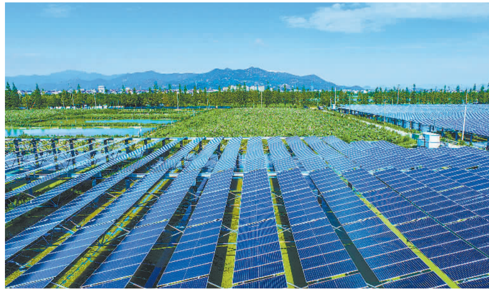
7月21日,浙江省三门县健跳镇三核村沁荷园渔光互补项目现场,一排排光伏发电板架设在荷塘内。今年以来,三门县推广“渔光互补”模式,水上实现光伏发电,水下发展渔业养殖,同步发展荷塘观光经济,全方位利用水域空间,实现生态产业融合、集约发展。 陈昌晖摄(中经视觉)
