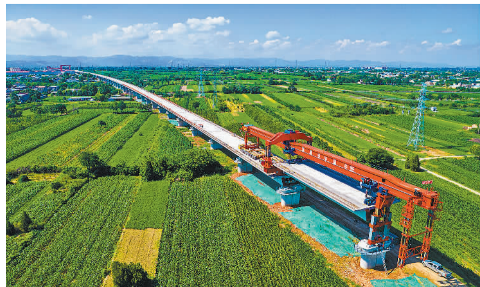
近日，陕西省富平县西安至延安高铁富平特大桥建设工地正在架设箱梁。西延高铁是我国“八纵八横”高铁网重要组成部分，项目建成后极大便利沿线人民群众出行，并带动沿线地区经济发展。 卢建建摄（中经视觉）
