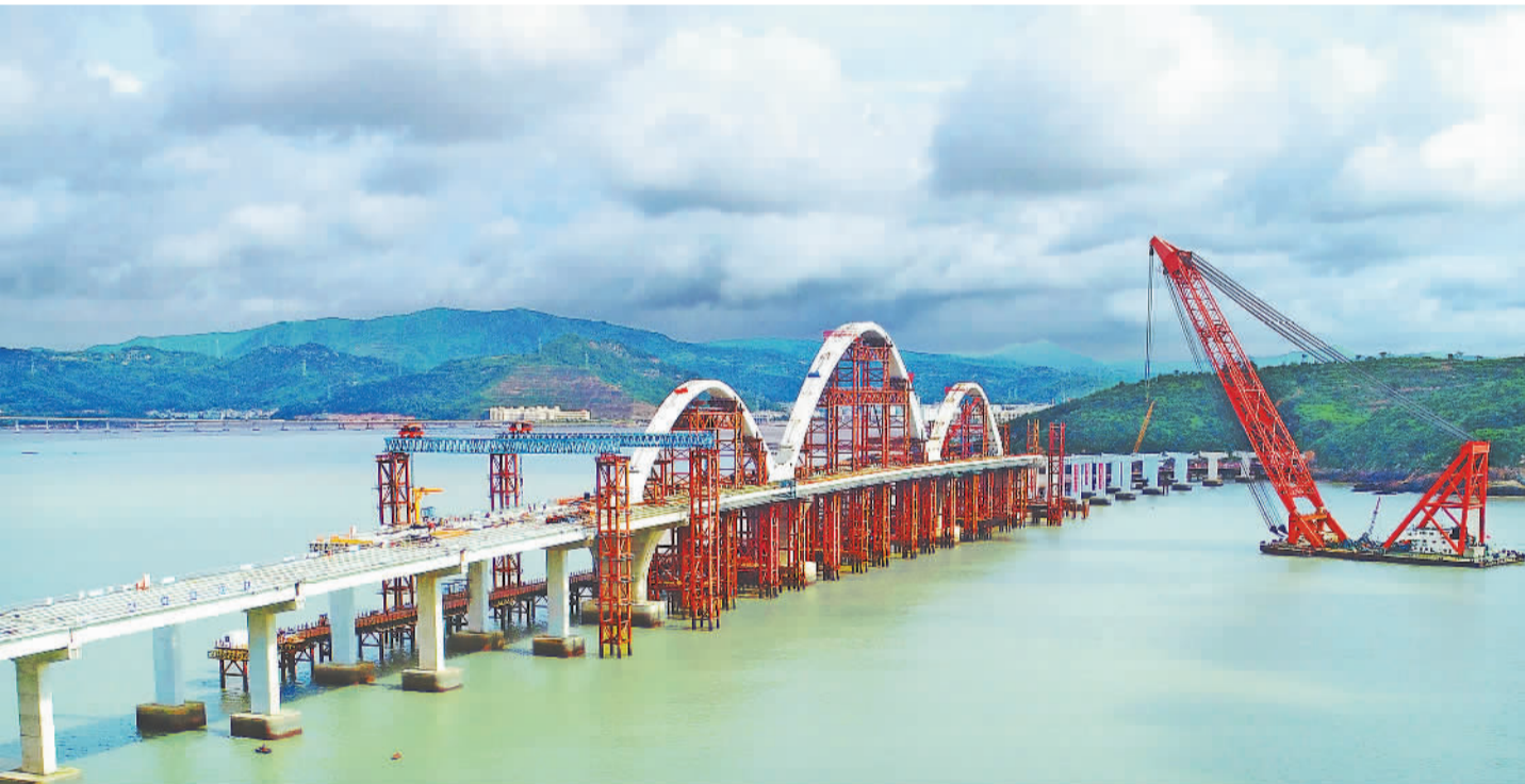
7月15日,浙江省玉环市干江镇台州1号公路西沙门大桥项目工地,工人加速推进海面桥梁施工。台州1号公路是一条联动推进临港产业发展、滨海旅游提质、沿线城镇开发的沿海公路,建成后带动沿线经济社会发展。
