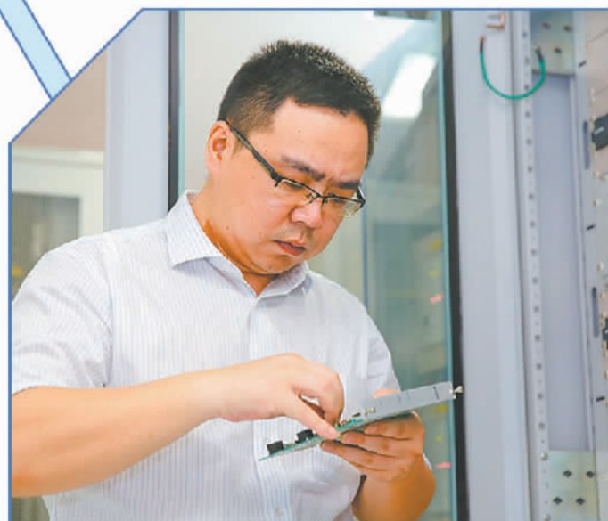
张霁明在机房对新投运的装置模块进行抽样检测。 洪浩哲摄（中经视觉）
