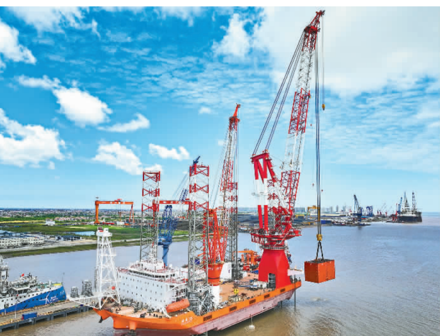
6月6日,我国自主研发设计、具有自主知识产权的1600吨自航自升式风电安装平台“海建020”进行1.1倍超载实验。“海建020”是最新一代集运输、自航、起重、安装、动力定位等多功能于一体的海上施工利器,为海上风电设备、基础施工提供更优解决方案。 许丛军摄(中经视觉)
