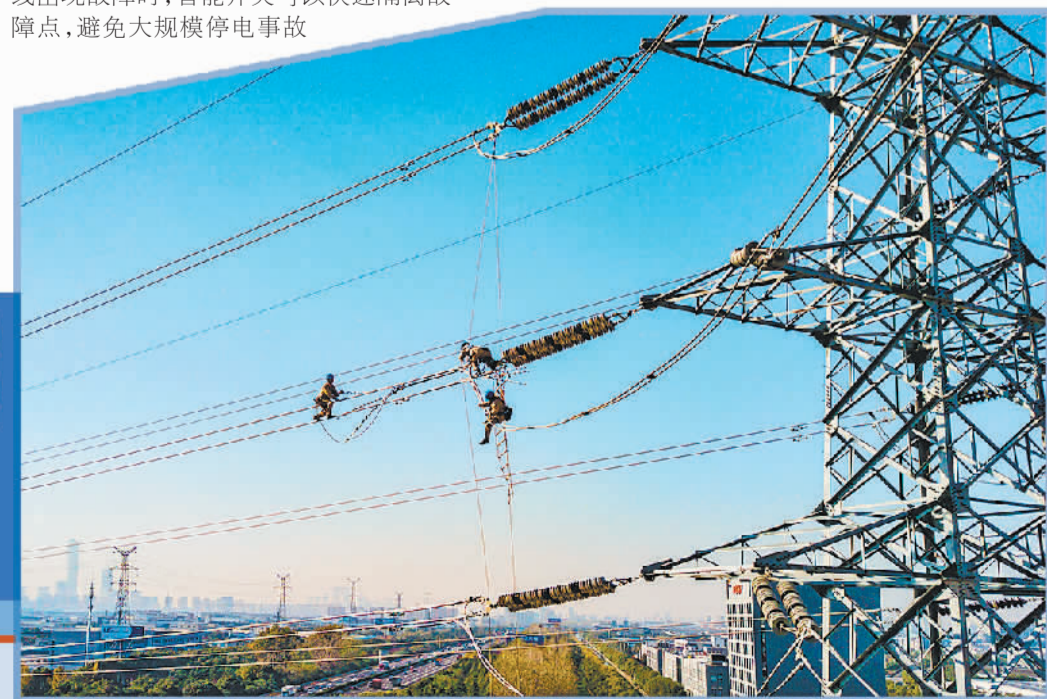
国网苏州供电公司工作人员对220千伏输电线路进行检修作业。
