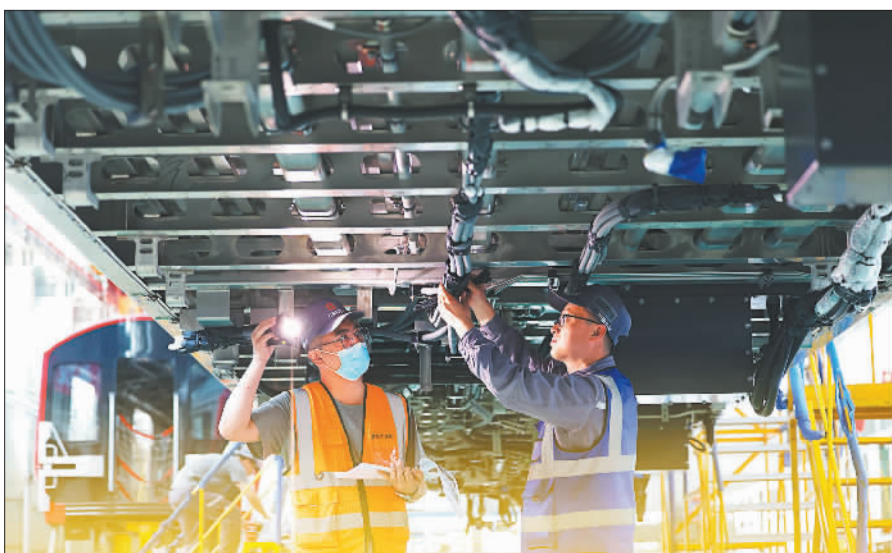
▼5月28日,中车长客城铁事业部制造中心装配产线组,员工进行地铁车辆车内布线作业。
