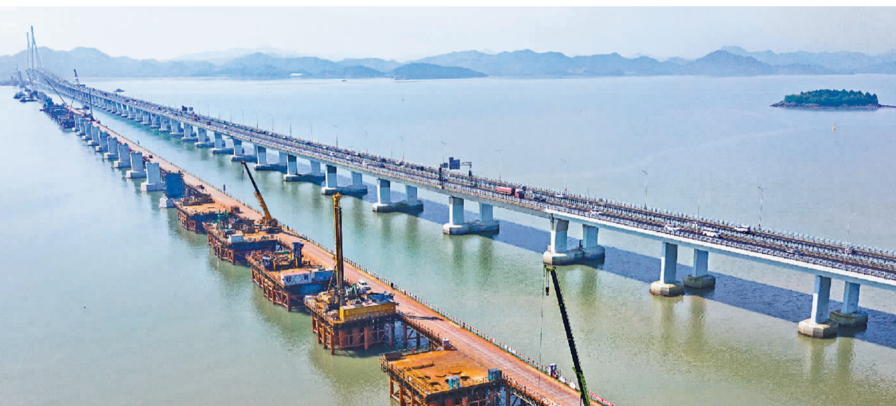
5月2日，浙江省宁波市象山港铁路跨海大桥施工现场，建设工人抢抓晴好天气，稳步推进项目进度。象山港跨海大桥全长8.26公里，是国内首座市域(郊)铁路跨海大桥。蒋晓东摄(中经视觉)
