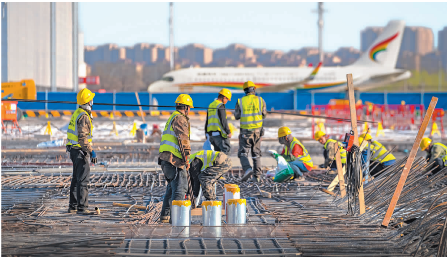
3月31日,天津市滨海新区,中国铁建大桥工程局集团有限公司承建的空客天津A320系列飞机第二条总装线项目——209总装厂房基础施工顺利完成,转入主体施工阶段。本报记者周琳摄
