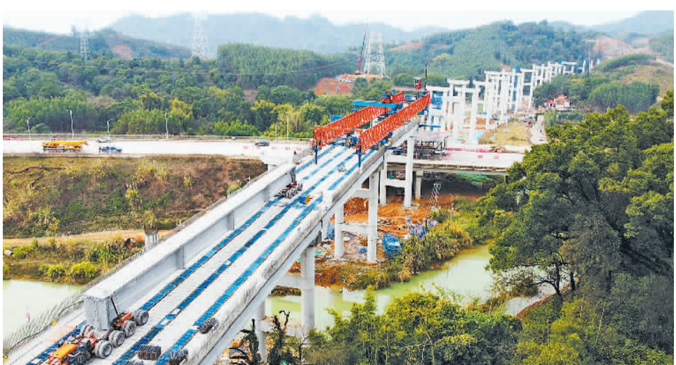
1月10日,广西贺州市平桂区西湾街道飞马村贺州北过境线公路飞马特大桥建设现场,建设者在紧张施工。该公路建成通车后将进一步完善广西高速公路网络,促进沿线地区经济发展。 黄旭胡摄(中经视觉)
