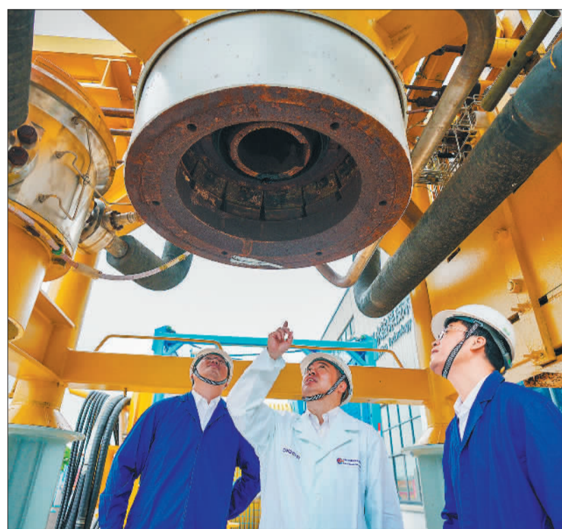
▼钻井技术专家和工程师对国产化深水水下采油树设备进行检查。
