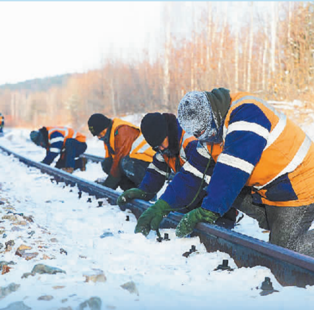
中国铁路哈尔滨局集团有限公司加格达奇工务段职工在极寒天气中向管内嫩林线540公里的小半径曲线发起攻坚战，保证设备使用状态良好。
