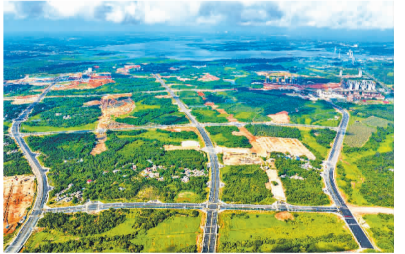
近日，由中铁上海设计院设计、中铁二十局建设的海南文昌国际航天城起步区“三横五纵”主干路网全面竣工通车，为园区航天产业加速集聚、重大项目落地、招商引资奠定坚实基础，对打造海南省经济社会高质量发展新引擎具有重要意义。 徐彬摄(中经视觉)
