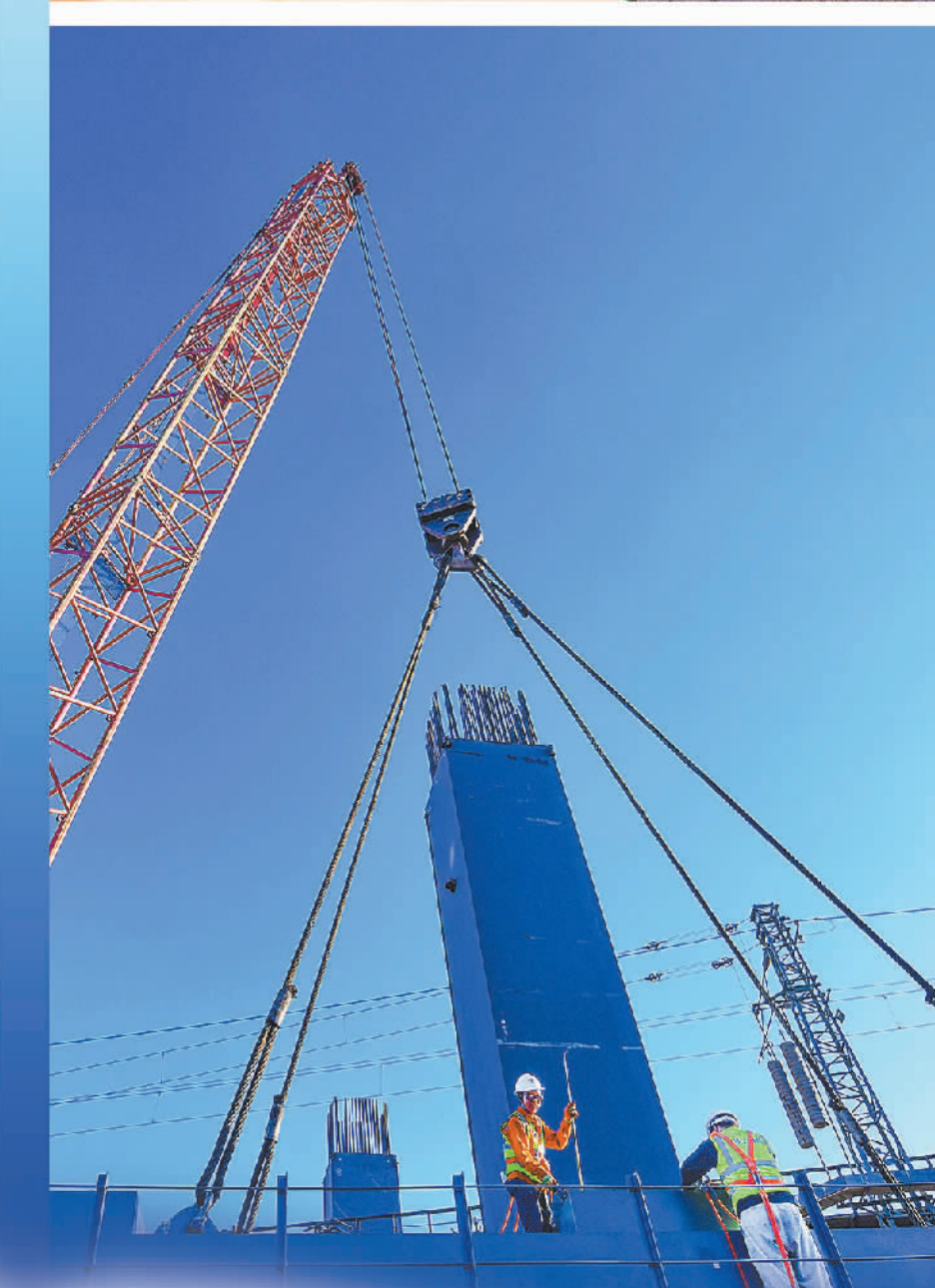
施工人员在包银高铁跨昆都仑河特大桥首榀门式墩钢梁吊装现场准备吊装。王亚摄(中经视觉)
