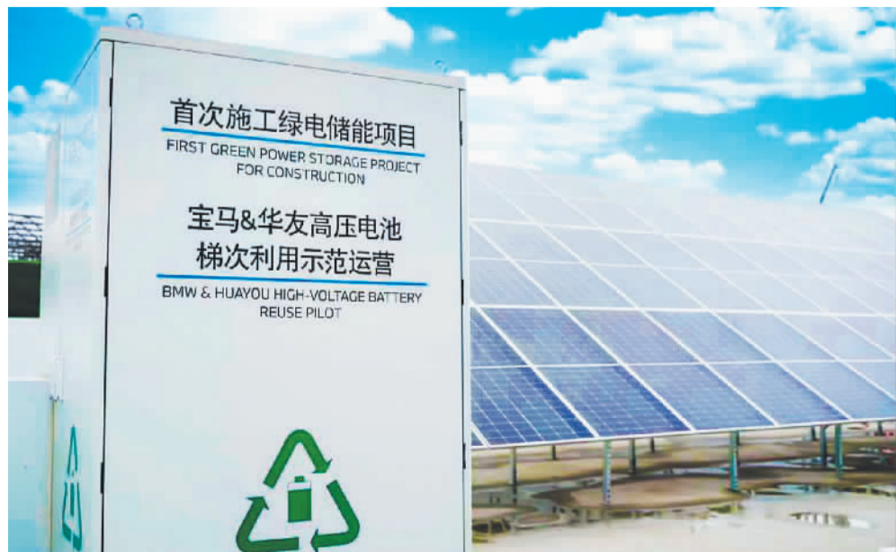
宝马动力电池梯次利用场景——铁西工厂里达厂区绿色光储一体站
