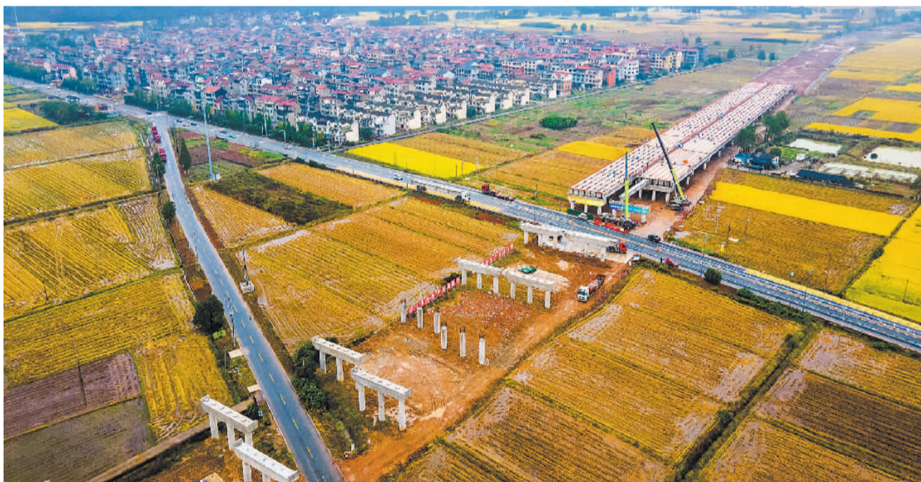
11月12日,航拍浙江省金华市婺城区蒋堂镇桃源村,浙江省“千项万亿”工程——建德至武义高速公路绕城段工程桃源大桥项目施工现场,梁板精准平稳地架设在桥墩上。该工程建成后将形成金华绕城高速西线,对加快金义都市区建设和金兰同城化、金武同城化进程具有重要作用。胡肖飞摄(中经视觉)
