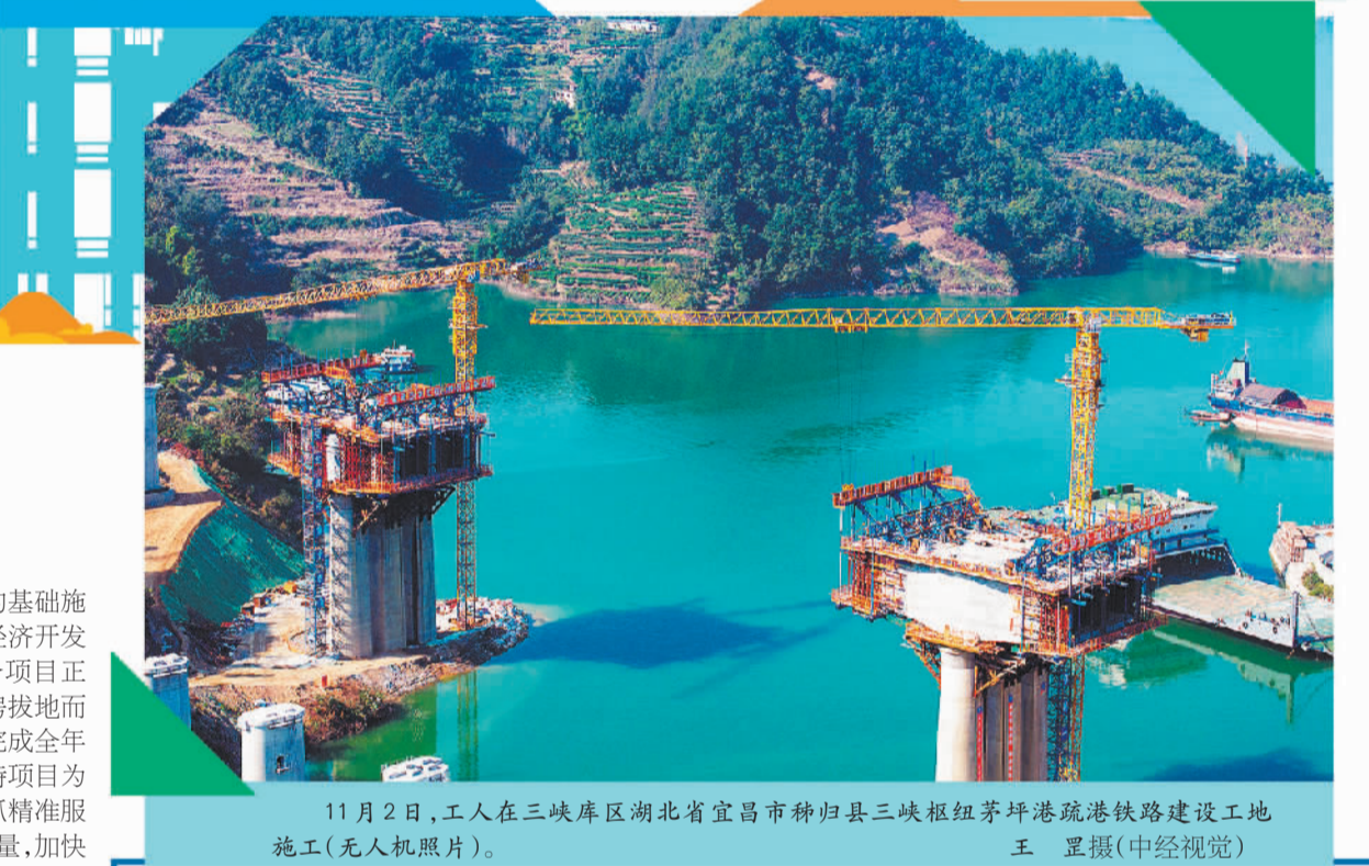
11月2日，工人在三峡库区湖北省宜昌市秭归县三峡枢纽茅坪港疏港铁路建设工地施工（无人机照片）。王 翌摄（中经视觉）
