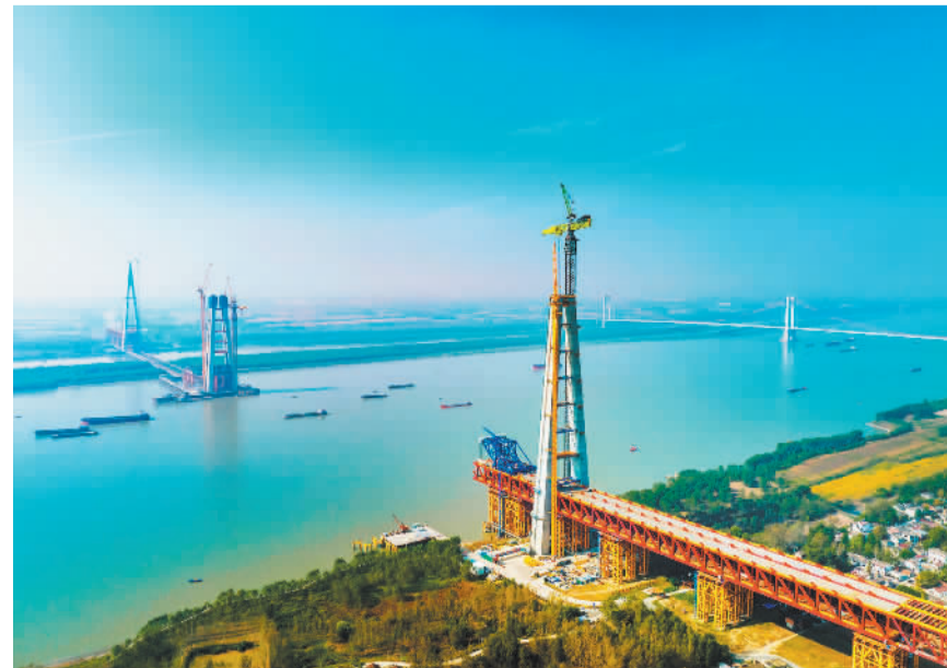
10月26日，巢马城际铁路安徽马鞍山长江公铁大桥正加紧建设。巢马城际铁路是沪汉蓉快速通道合肥至上海间的重要组成部分，该铁路的建设，对进一步完善区域高速铁路网布局，促进长三角一体化发展具有重要意义。张明伟摄（中经视觉）
