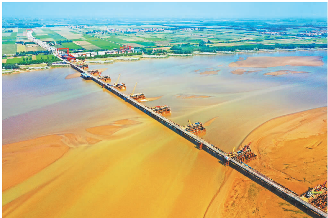
10月3日,河南沁伊高速(焦作市沁阳—洛阳市伊川)孟州黄河特大桥项目建设现场,建设者在中秋国庆假期坚守岗位,加紧施工。沁伊高速是河南省“十四五”规划重要项目,是洛阳都市环线公路重要组成部分,线路总长98.99公里,工程造价188.74亿元,计划2025年12月建成通车。白水平摄(中经视觉)
