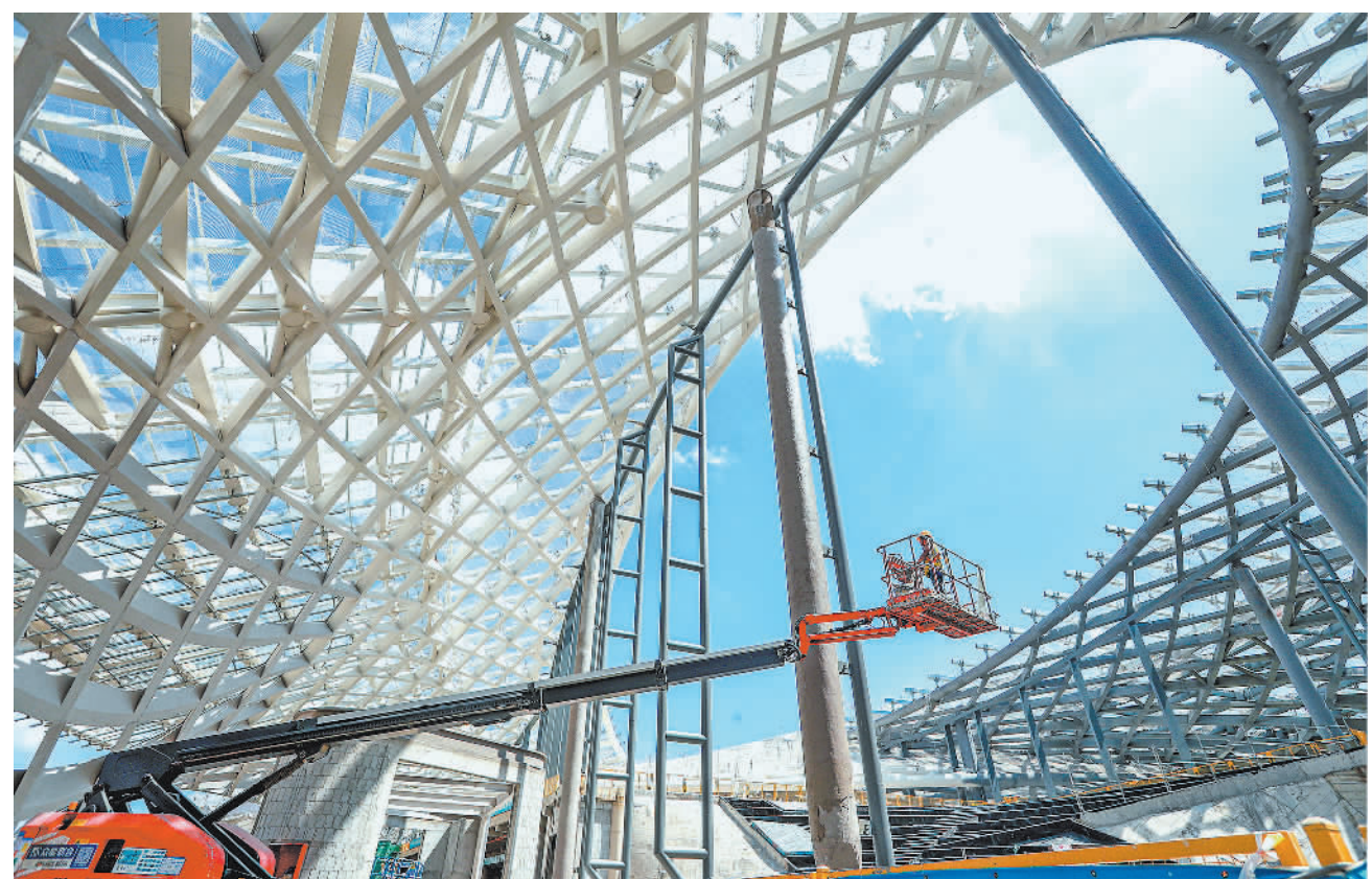
9月19日,浙江省台州机场改扩建项目施工现场,工人正在进行墙面喷漆等装修工作。据了解,台州机场改扩建项目总投资约35.88亿元,项目完工后年旅客吞吐量将提升至250万人次。孙金摄(中经视觉)
